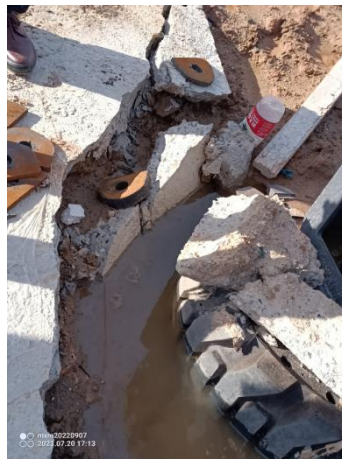
图 4：倾覆位置及硬化地面断裂情况
