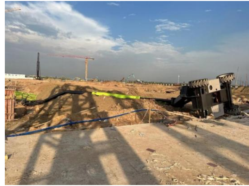
图 3：高空作业平台倒伏状态
