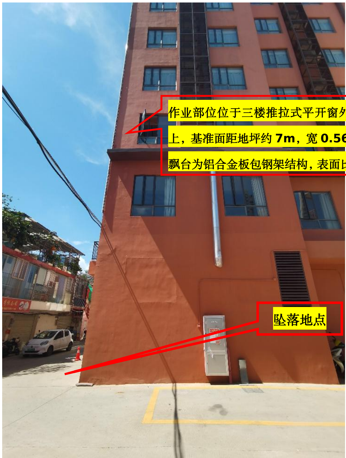
附图 1.18 从地面观察三楼窗外空调安装作业飘台
